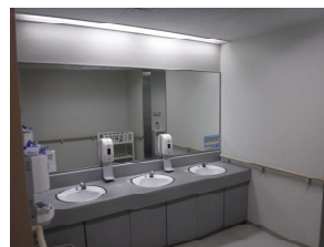
老朽化した洗面台
